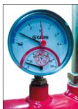
Термоманометр на выходе котла
