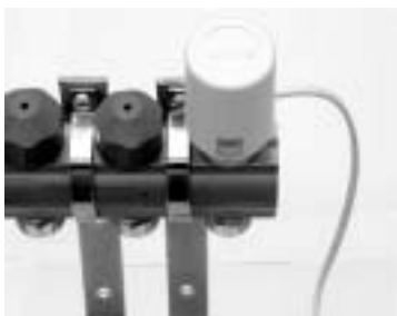
Рис. 154a. Электрический сервомотор установлен на запорном вентиле, вмонтированном на подающем коллекторе распределителя.
